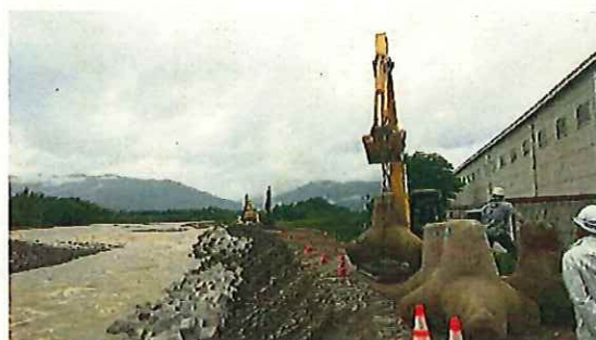
令和3年8月 信濃川水系犀川での堤防欠損箇所へのブロック投入
